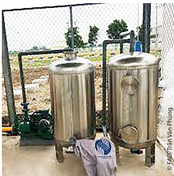
Hình 46. Hệ thống thiết bị lọc khí H_2S
